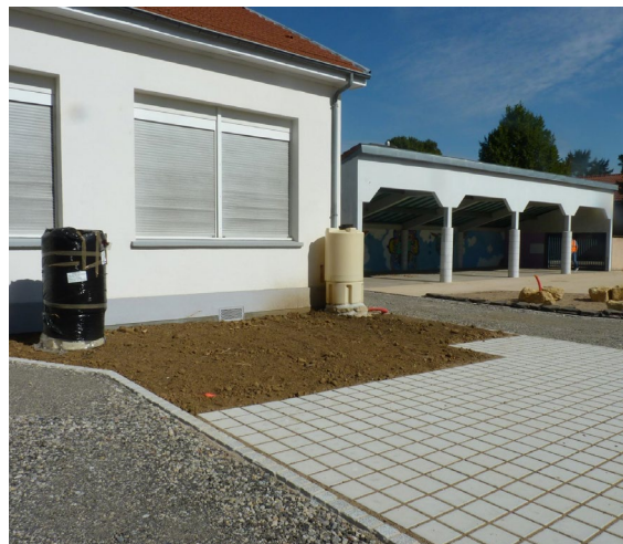
Cuves de stockage d'eau de pluie pour arrosage ponctuel
